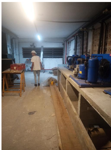
Vista de area de máquinas
