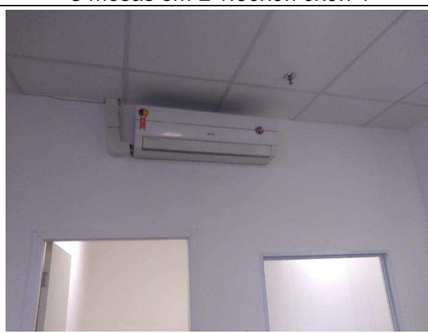
4 aparelhos de ar condicionado Gree
